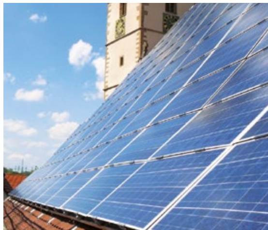
Photovoltaikanlage ev. Gemeindehaus Neckarweihingen © Solarinitiative Ludwigsburg
